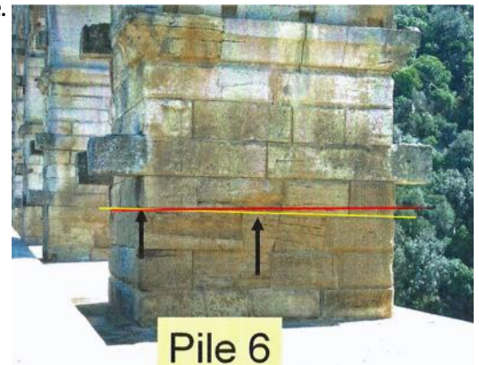
Pile 6 : le trait rouge marque l'horizontale, le jaune le joint de lit de blocs
